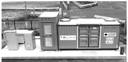
納入したレドックスフロー電池
